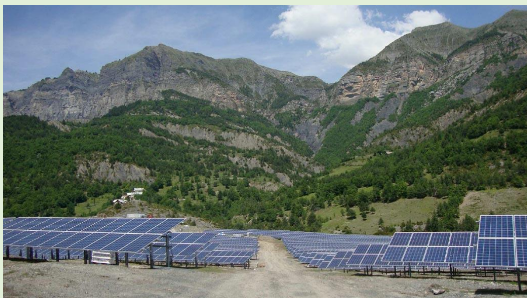
Figure 27 Centrale de Villeneuve d'Entraunes (photo Enerparc)
